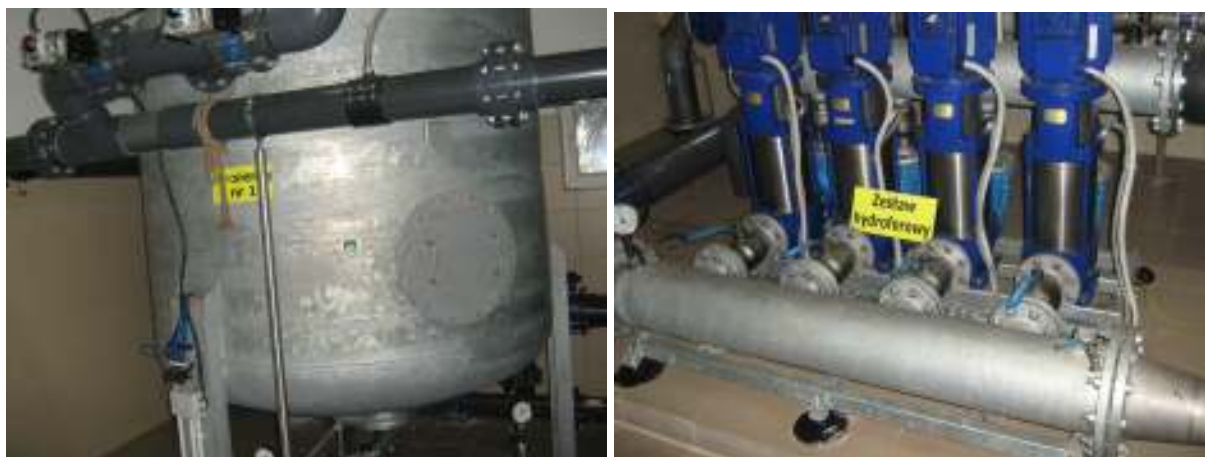
Urządzenia wodne w stacji uzdatniania wody w Mroczy.
