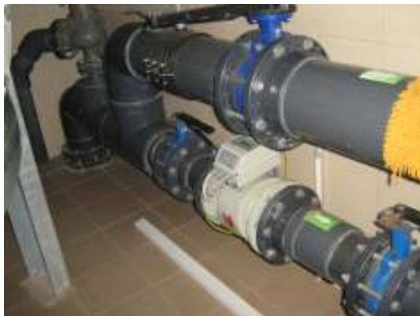
Urządzenia wodne w stacji uzdatniania wody w Mroczy.
