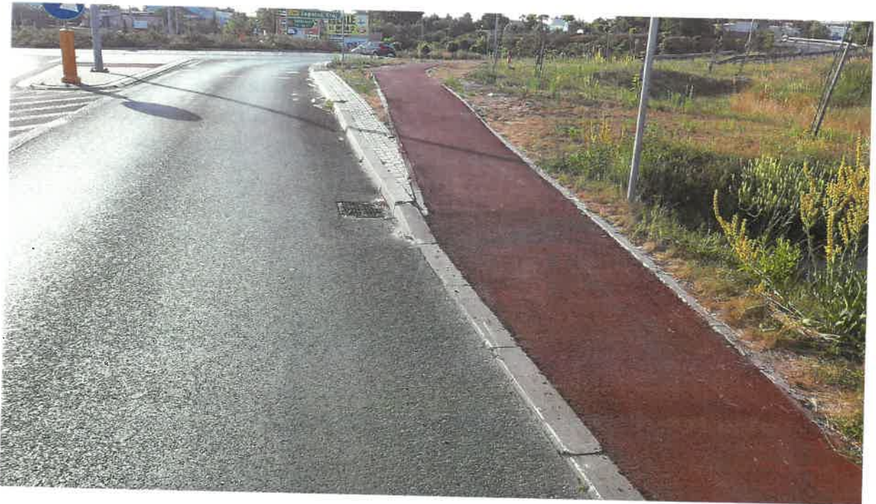
Fot. 1. Wlot na rondo od strony Potulic, zapadnięta jezdnia
