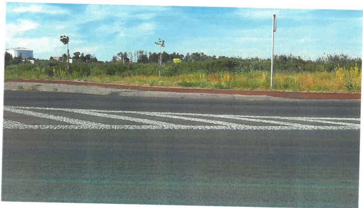
Fot. 2. Wlot na rondo od strony Potulic, zapadnięta jezdnia
